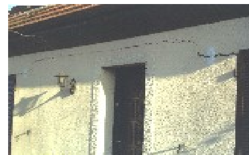
Désordres sur le bâti (maisons individuelles les plus vulnérables)
